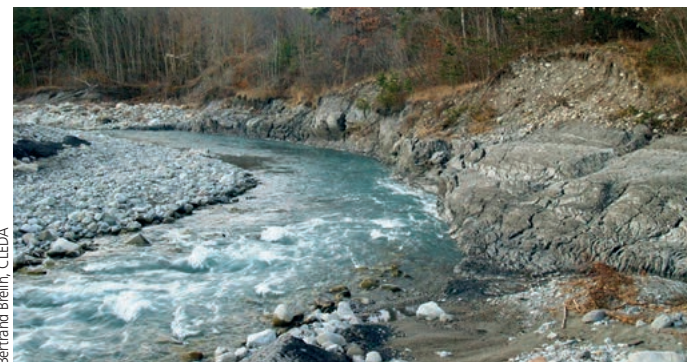
Incision du lit du Drac dans les argiles, dépérissement de la ripisylve et glissement de terrain en novembre 2011.
