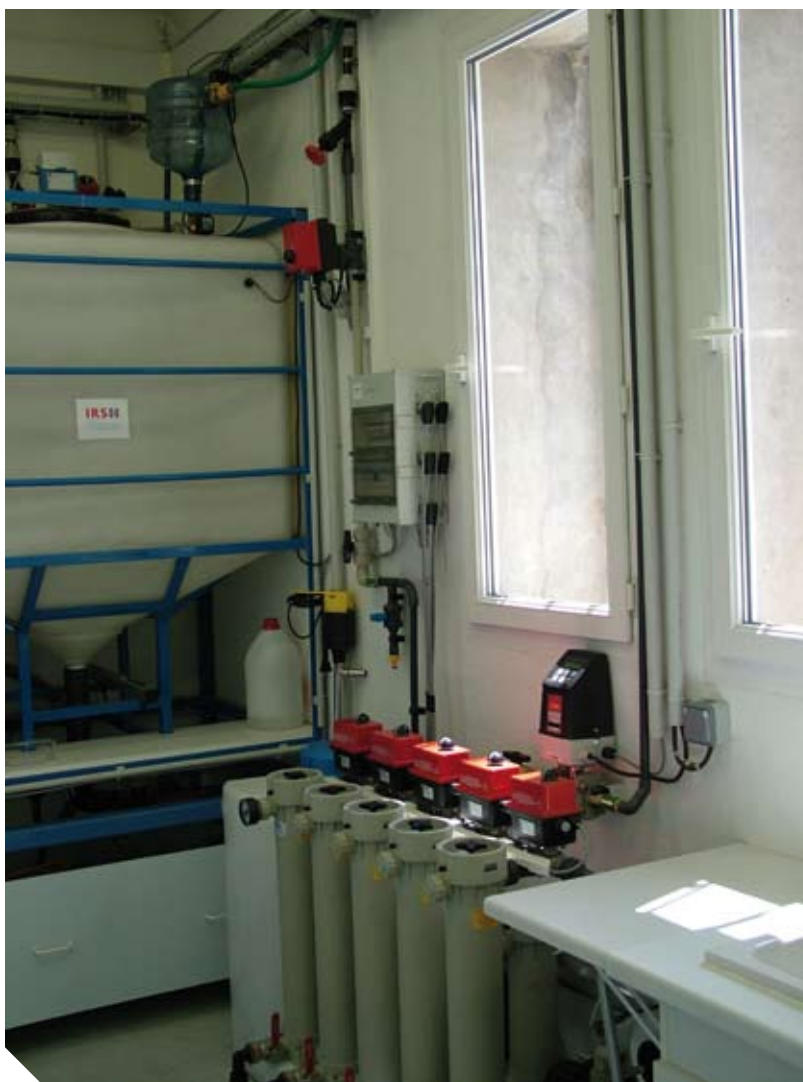
Station SORA : unité de filtration et de stockage d'eau filtrée pour l'étude des concentrations en radionucléides au cours de la montée de crue au niveau d'Arles (© O. Masson, IRSN)
