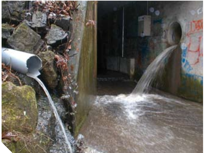
Déversoir d'orage de Grézieux-la-Varenne – 69 (© Cemagref)
