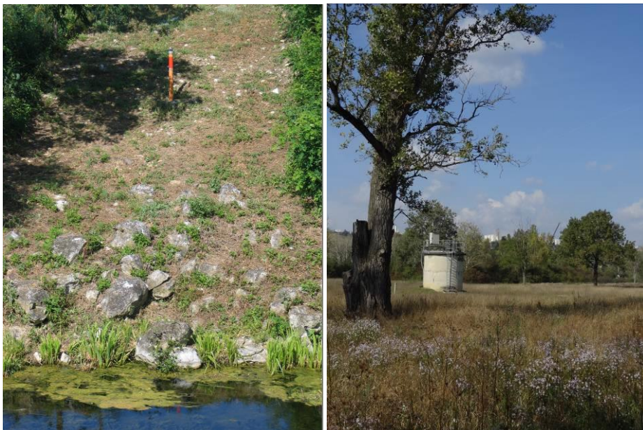
A gauche - Un piézomètre de digue de la CNR à Péage-de-Roussillon (38). Ce type d'ouvrage permet de surveiller le niveau d'eau dans les digues (© F. Paran)
