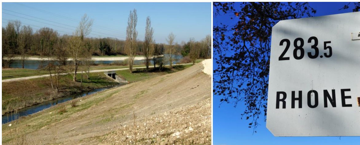
A gauche - Un contre-canal en pied de digue entre canal dérivation et Vieux-Rhône à proximité de Brégnier-Cordon (01). Les contre-canaux recueillent les eaux de fuites des digues et potentiellement des eaux souterraines (© F. Paran)
